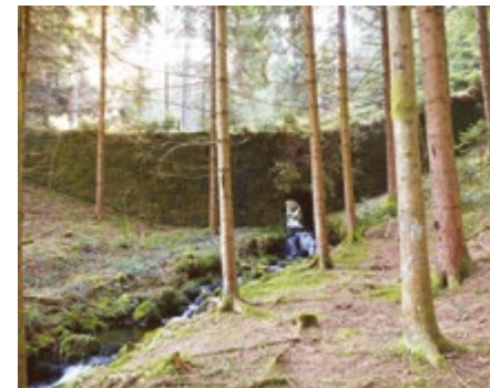
Reste einer Sandsteinmauer, die als Unterbau einer Holz-Riese bei Bad Rippoldsau Verwendung fand
